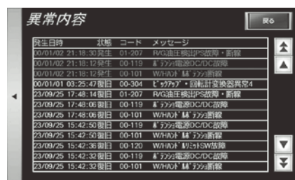
図-2 タッチパネル異常画面
