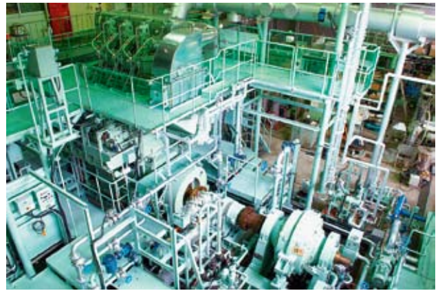
東京海洋大学殿に設置された 実験・実習ディーゼルプラント (関連記事は4～6ページ)
