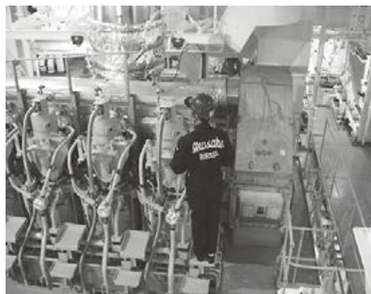
エンジンルームで各部を点検中の様子
