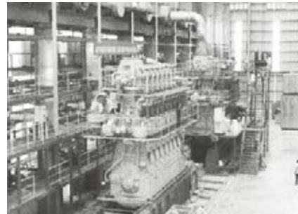
試運転工場 奥が調整運転中の3号機、手前が出荷を待つ2号機
