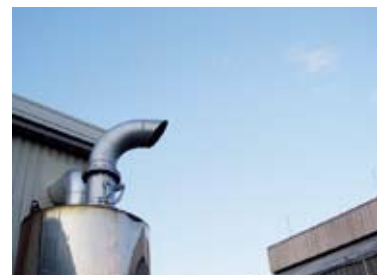
DPFを通した後の排ガス色
