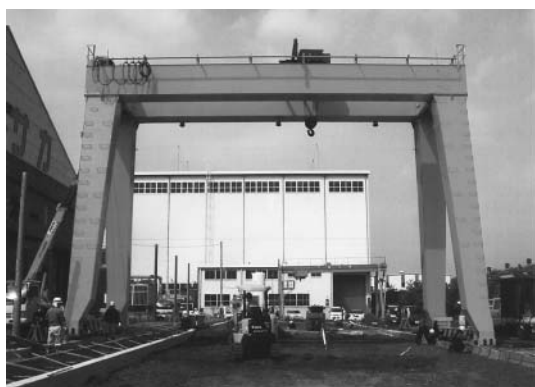
写真-1 大形ヤードクレーン
