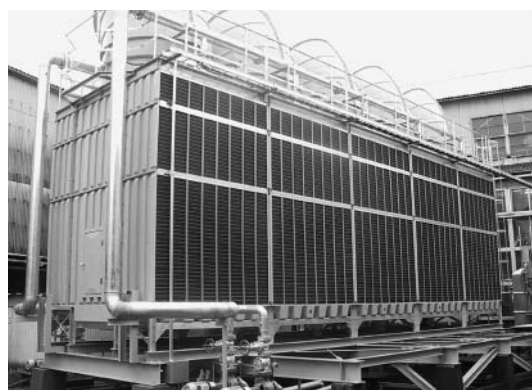
写真-2 クーリングタワー
