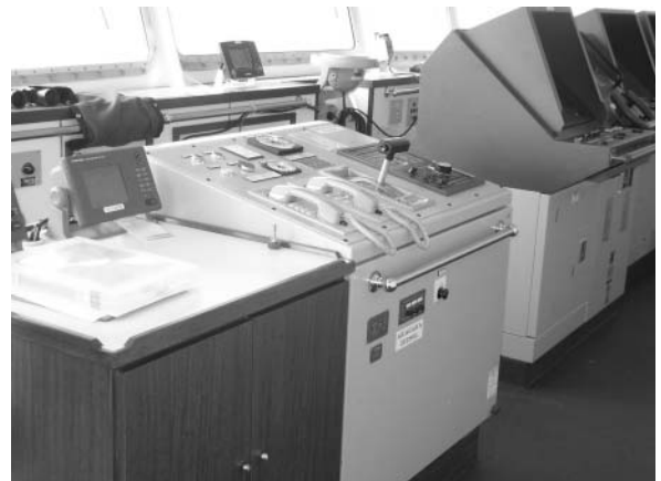
写真-1 ほだか丸の操舵室操縦台 (右舷側と左舷側に各1台装備)
